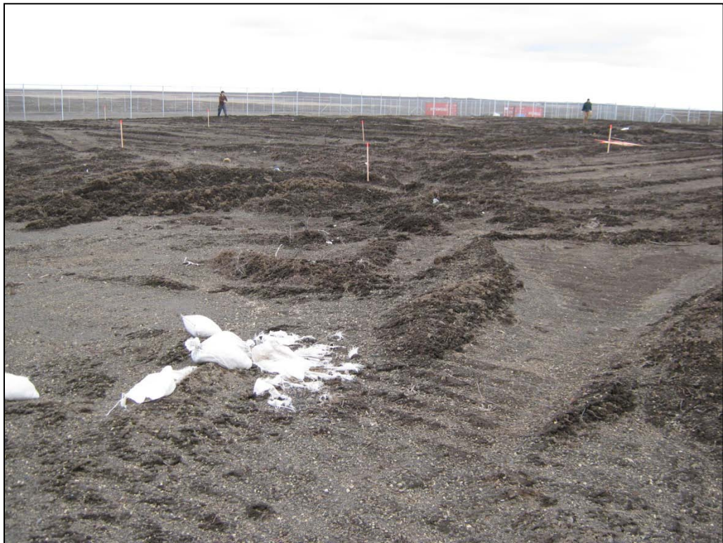
Photo 12. Uneven Landfill Surface
